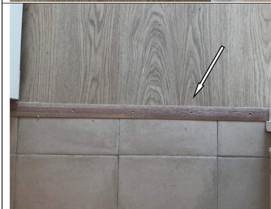
Фото №20. Металлический порожек в спальне не закреплен.
