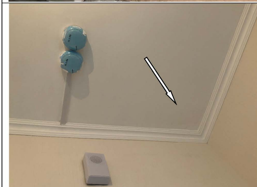
Фото №35. Дефект окрашенного потолка в коридоре.
