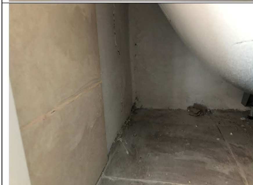
Фото №44. Частично отсутствует настенная керамическая плитка в ванной комнате.
