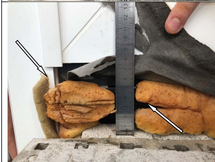
Фото №47. Дефект монтажа оконного блока ПВХ на лоджии.
