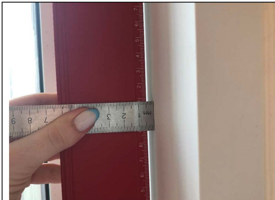
Фото №16. Измерение уровня дверного блока ПВХ в кухне на лоджию.
