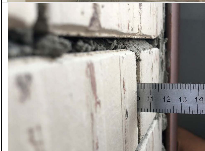
Фото №45. Дефект заполнения швов кирпичной кладки раствором на лоджии.
