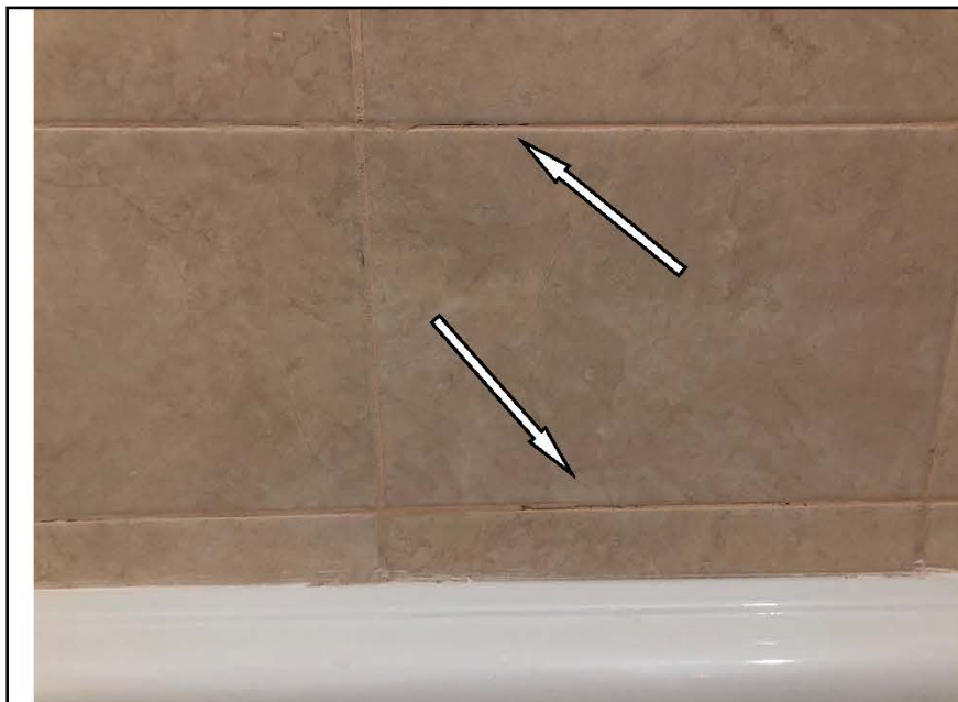
Фото №43. Дефект шва настенной плитки в ванной комнате.
