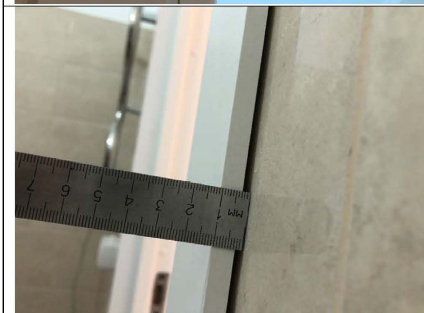
Фото №33. Наличник дверного блока не прилегает к стене в ванной комнате.
