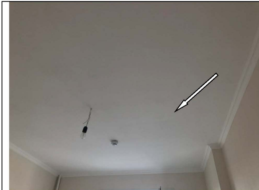
Фото №37. Дефект окрашенного потолка в кухне.
