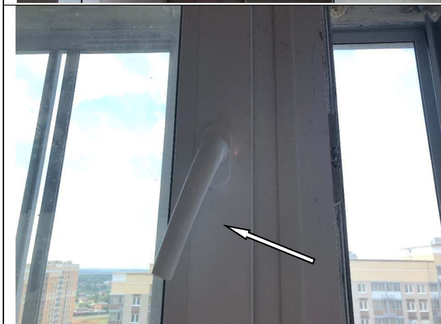
Фото №29. Фурнитура оконного блока в кухне не отрегулирована.
