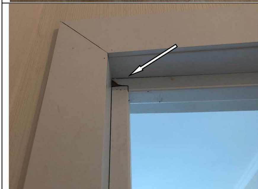
Фото №32. Дефект дверной коробки в кухне.
