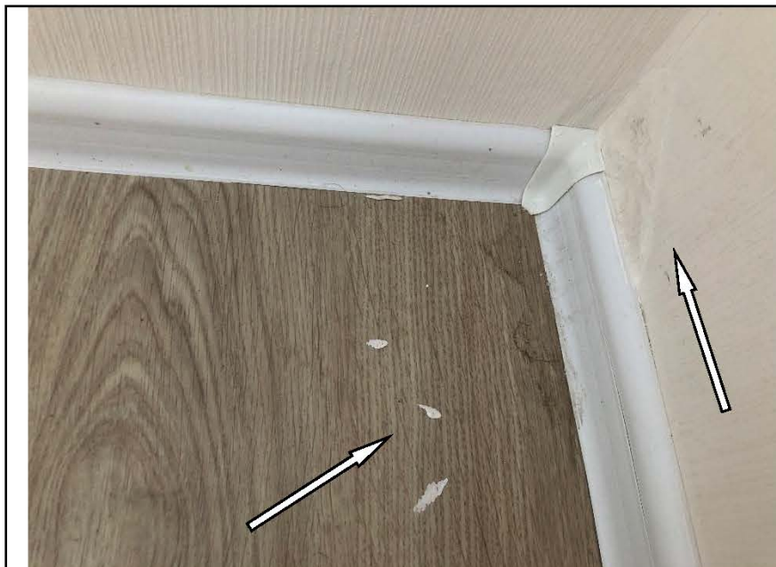
Фото №19. Загрязнение напольного покрытия в спальне. Дефект оклейки обоями.
