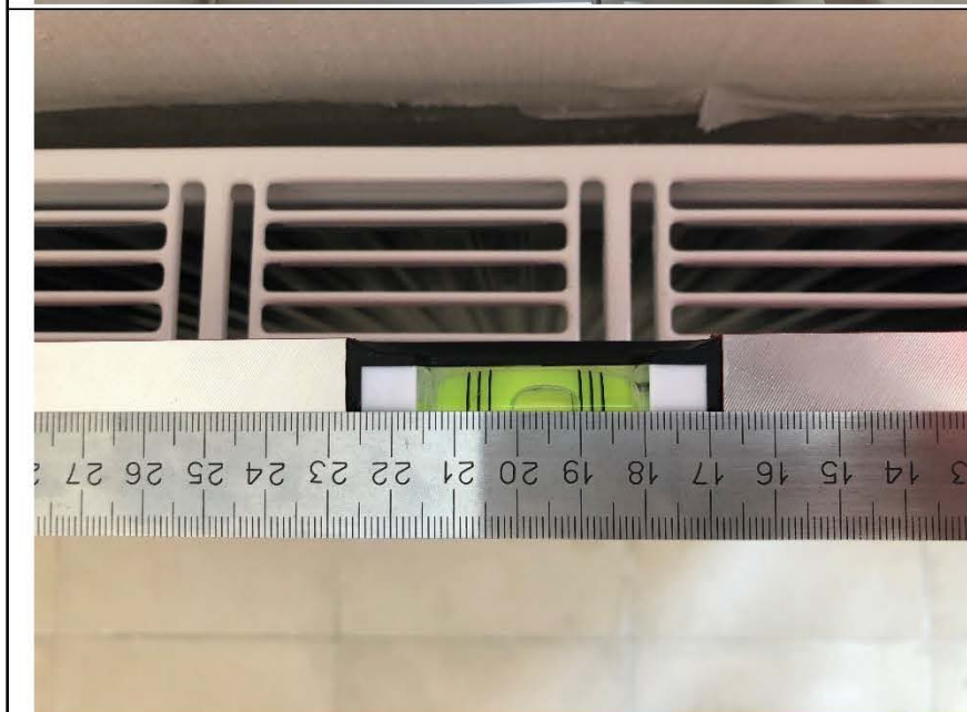
Фото №38. Неверно смонтированный отопительный прибор в кухне.
