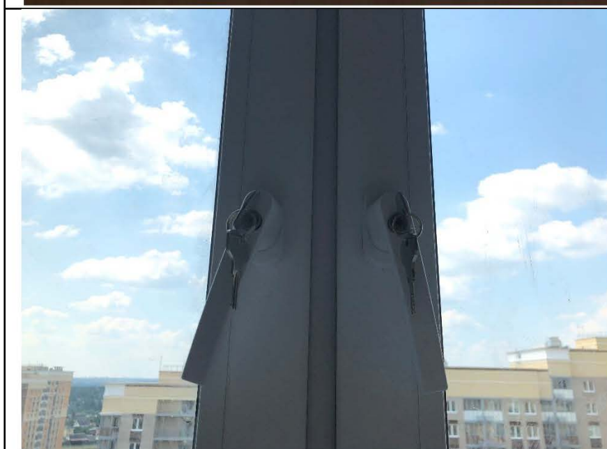
Фото №24. Фурнитура оконного блока в спальне не отрегулирована.
