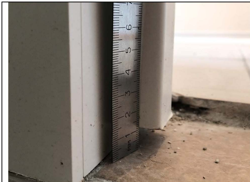
Фото №34. Дефект дверной коробки в ванной комнате.
