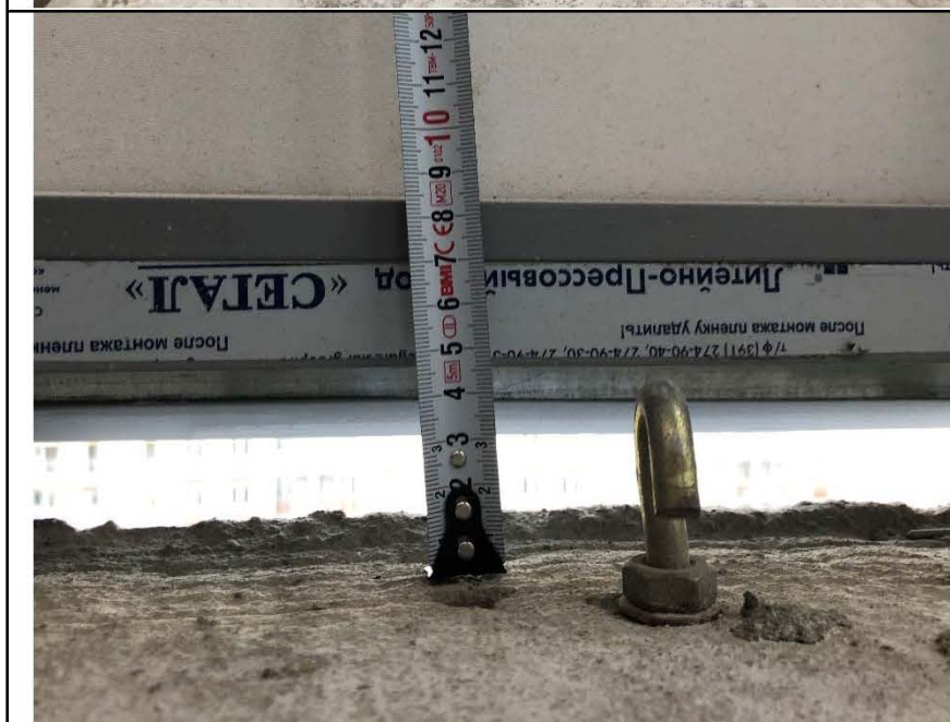
Фото №48. Дефект монтажа оконного блока с ограждением на лоджии.
