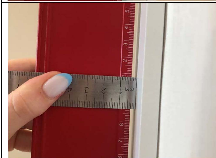
Фото №14. Измерение уровня наличника двери в кухне.
