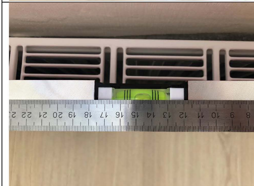
Фото №39. Неверно смонтированный отопительный прибор в спальне.
