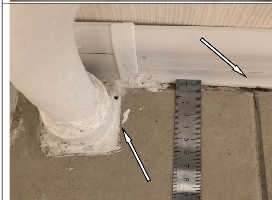
Фото №21. Отсутствует затирочный шов и имеются загрязнения напольной плитки в кухне.
