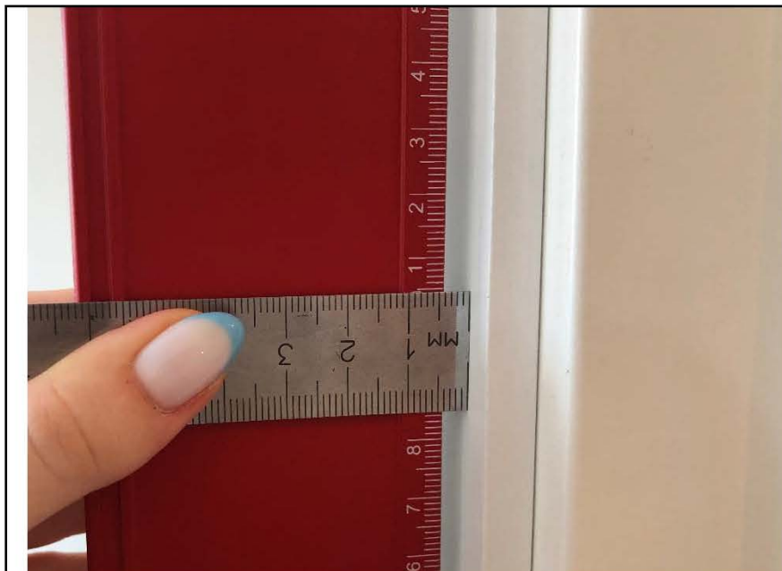
Фото №13. Измерение уровня наличника двери в спальне.
