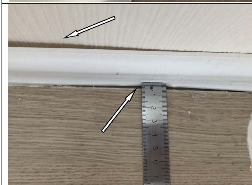
Фото №18. Часть ламината отсутствует в спальне. Плинтус не прилегает к стене.
